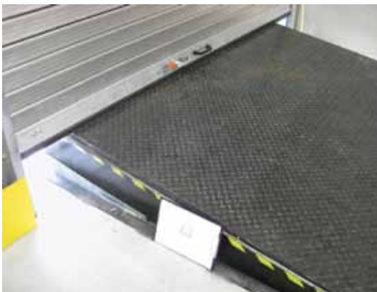
Fehlende Verriegelung der Torsteuerung mit der Rampensteuerung
