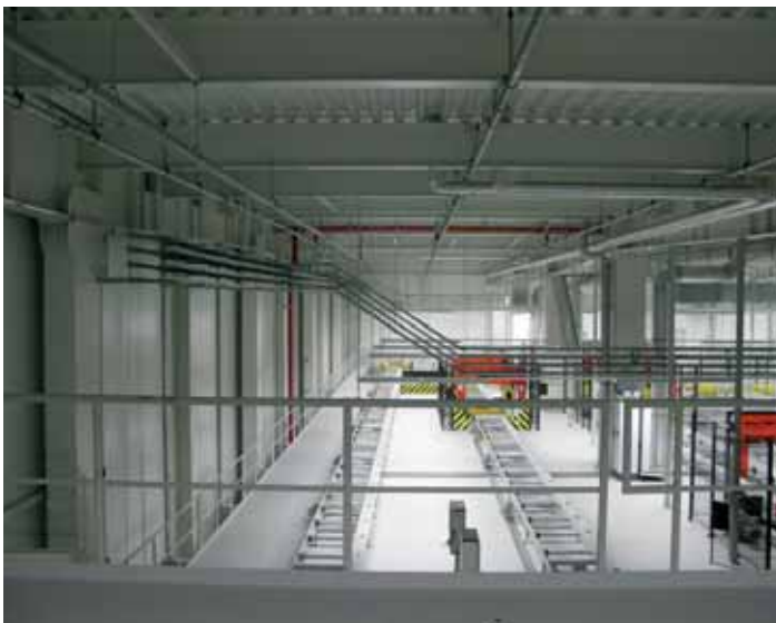
Im Bereich der Lackierung wird ein innovatives Verfahren der Trockenabscheidung genutzt.
